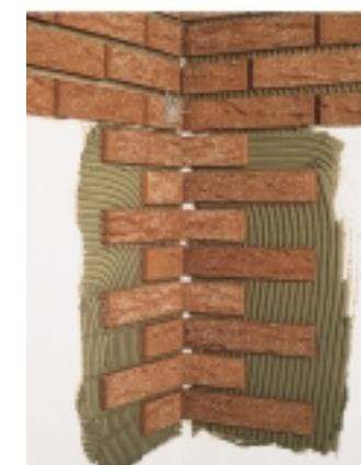
3. ...altrettanto vale per gli angoli interni. Dove servono mezzi listelli si rompono col martello oppure, ancora meglio, si tagliano.
