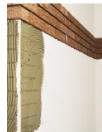
1. Incollare le prime tre file sotto alla linea disegnata a matita. Il letto di malta per i successivi tre listelli angolari è pronto.
